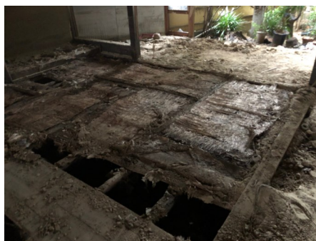
畳は腐敗し床下にも大量の土砂
